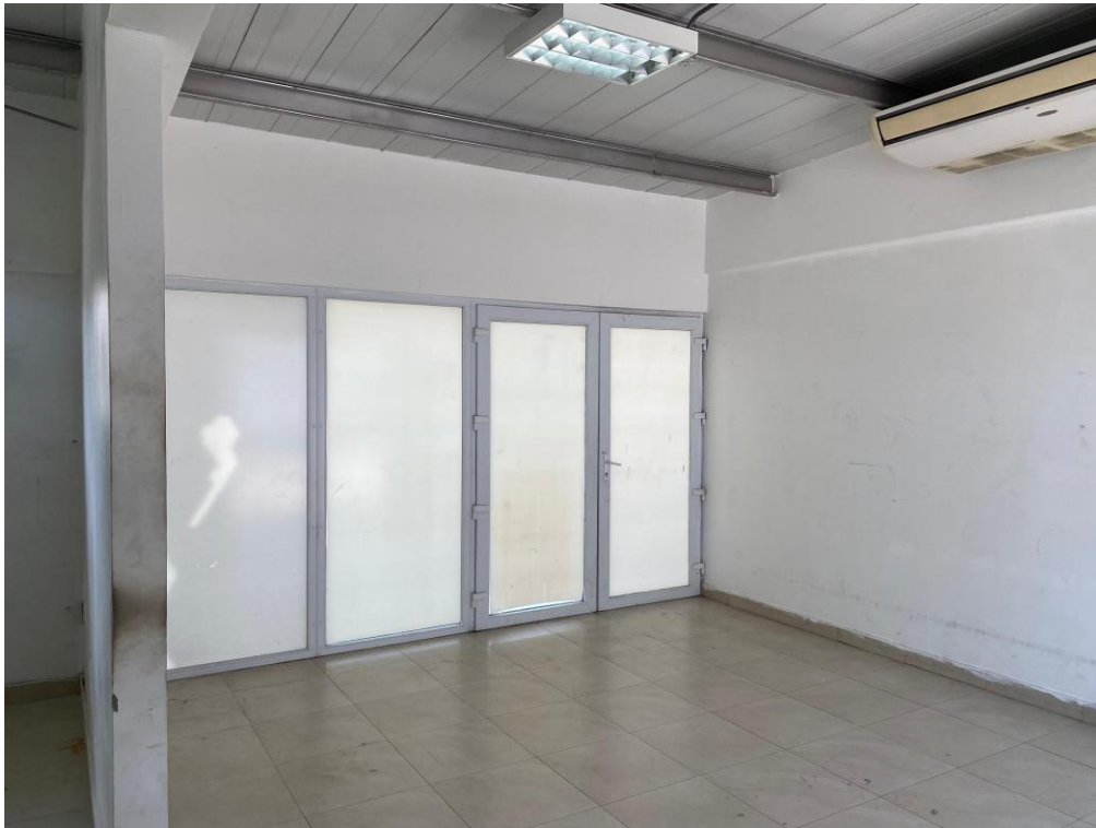
Bodega AERO EXPRESO 1 (Luminarias, Aire Acondicionado SPLIT 12000 btu, Puertas y ventanas en aluminio y vidrio)
