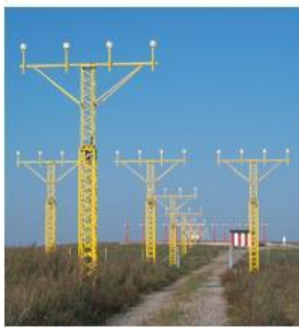
Figura 2-8-2. Torres de iluminación de aproximación de fibra de vidrio
