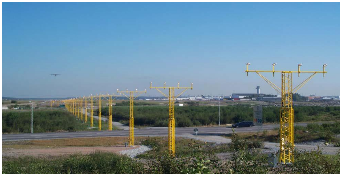
Figura 2-6-2. Torres de iluminación de aproximación — Estructuras reticulares de fibra de vidrio
