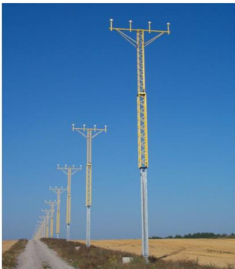
Figura 2-8 Torres de iluminación de aproximación de fibra de vidrio sobre estructuras de soporte rígidas
