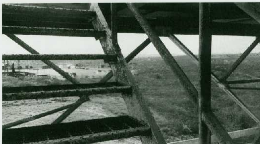
Figura 4. Estructura metálica radar sin mantenimiento.
