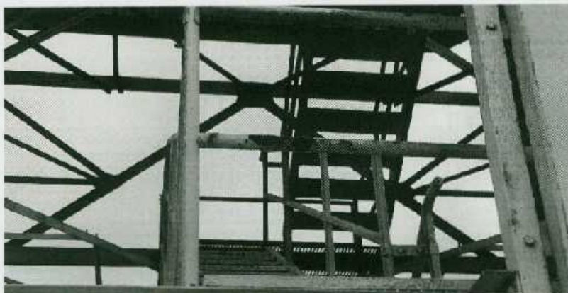
Figura 3. Estructura metálica radar con herrumbre.
