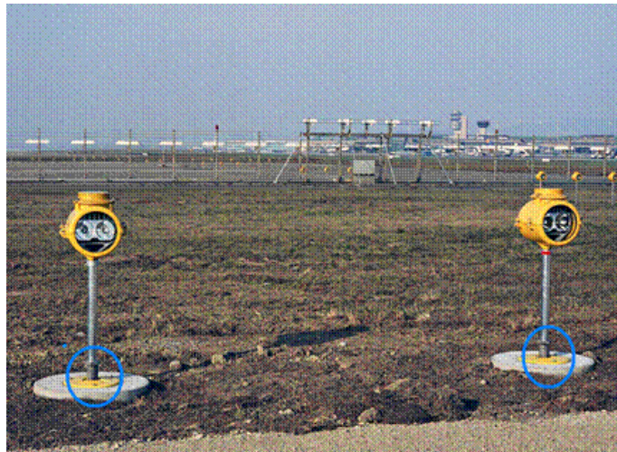
Figura 2-6-4. Ejemplos de Cuplas Frangibles montaje de tubos en luces de aproximación
