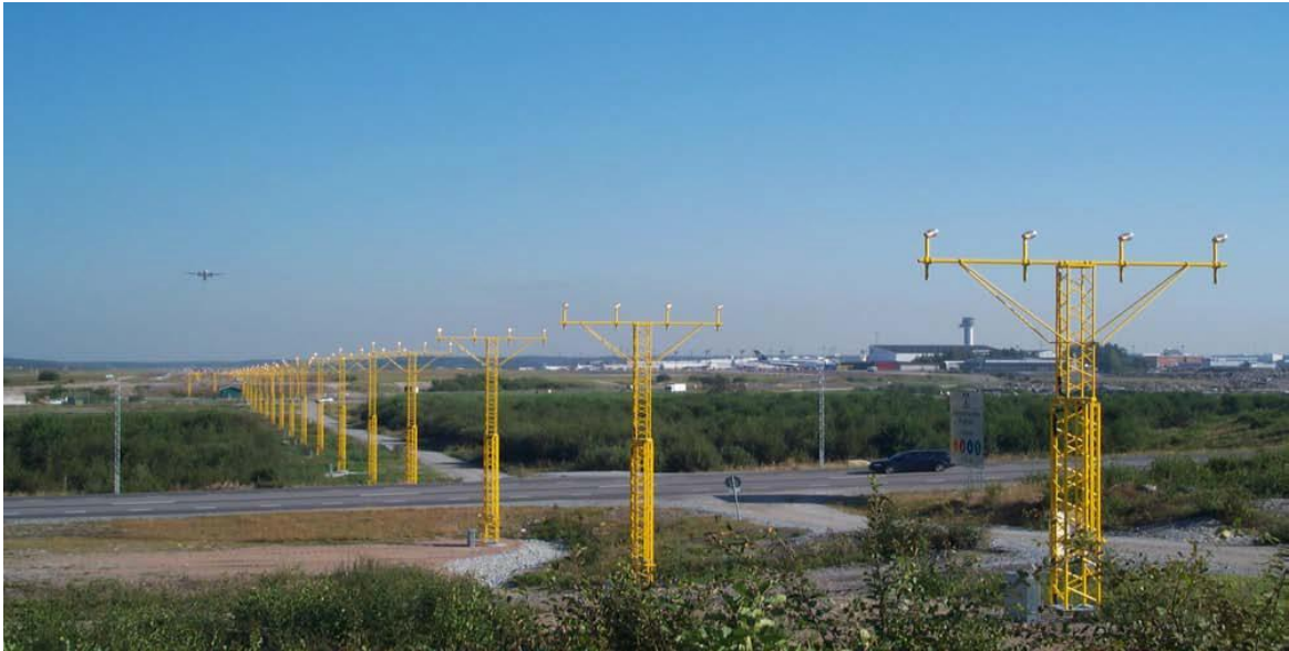
Figura 2-6-2. Torres de iluminación de aproximación — Estructuras reticulares de fibra de vidrio
