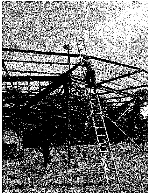
Figura 6. Revisión de antenas DVOR y antena monitora.
